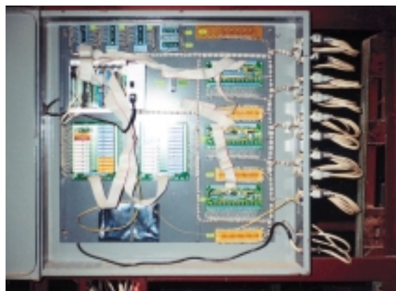
Рис. 8. Общий вид щита контроллера
