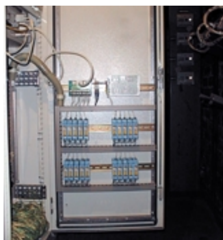
Рис. 5. Вид шкафа с открытой задней дверью
