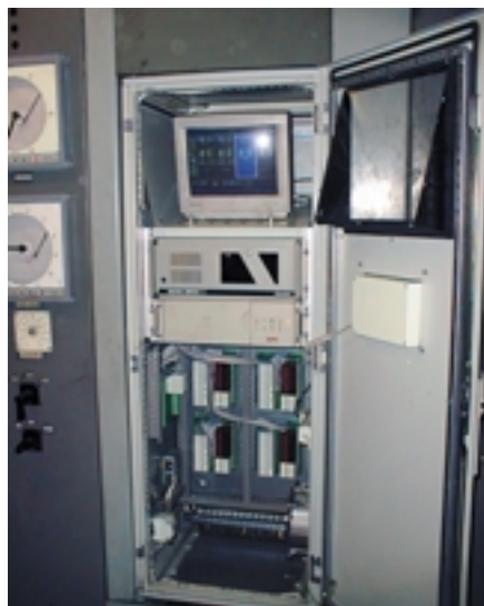
Рис. 4. Вид шкафа с открытой дверью спереди
