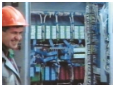
Рис. 3. Шкаф с контроллером MicroPC
