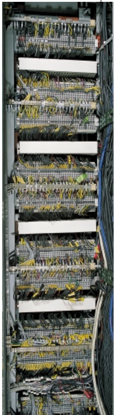
Типичный шкаф управления на железной дороге с клеммами Wago фронтального электромонтажа
