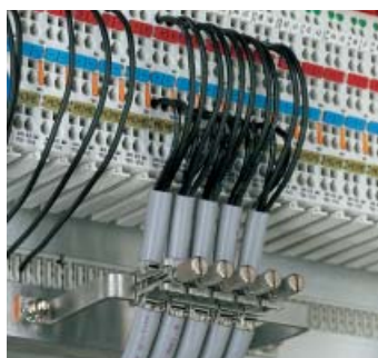
Установка на кронштейне
