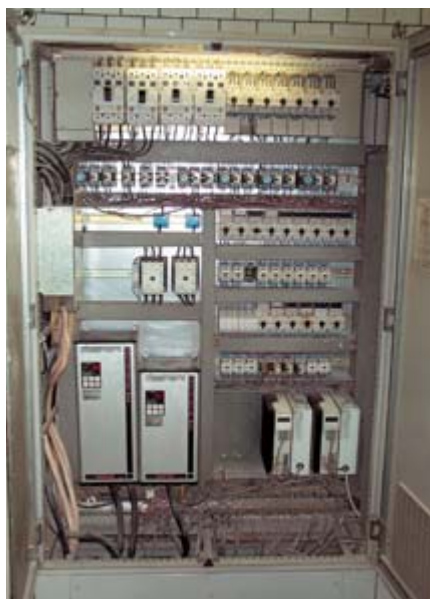
Рис. 4. Силовая секция шкафа управления
