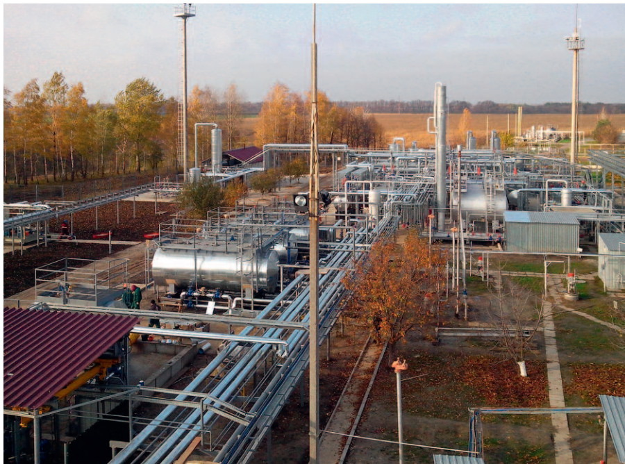
Рис. 2. Установка комплексной подготовки газа
