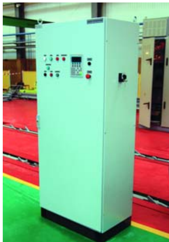
Рис. 6. Щитовое электрооборудование подсистемы № 11
