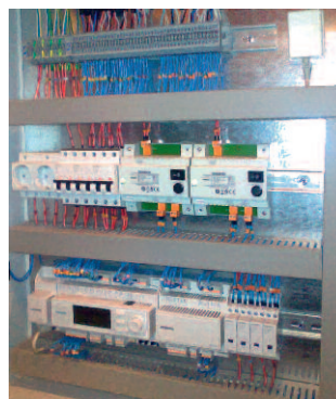
Рис. 3. Щит управления ИТП
