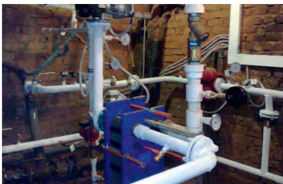
Рис. 2. Индивидуальный тепловой пункт
