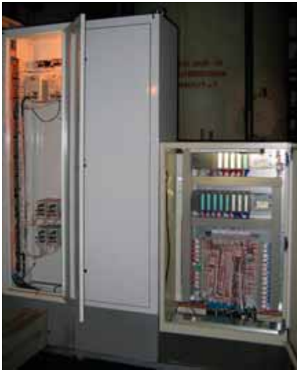
Рис. 3. Шкафы контроллера и вторичных приборов блока фильтров
