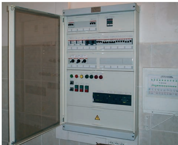
Рис. 3. Щит ЩА-1 в помещении насосной
