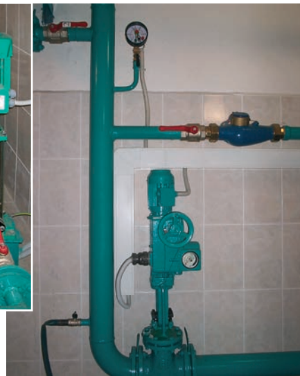
Рис. 7. Обводная задвижка, водомер и электроконтактный манометр
