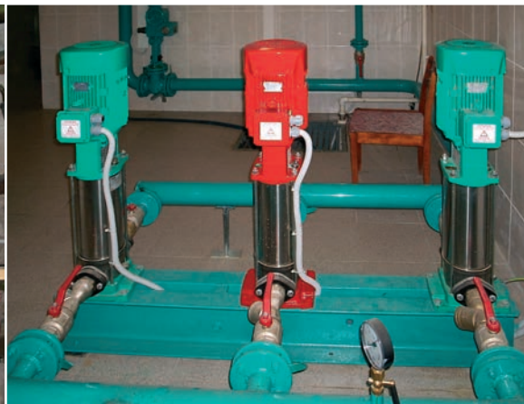
Рис. 6. Подающие насосы новой насосной
