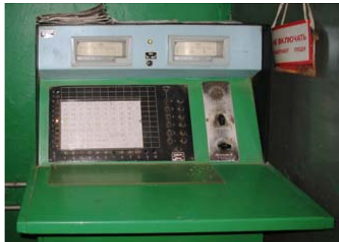
Рис. 2. Пульт управления устаревшей системы ДКТЭ-4М
