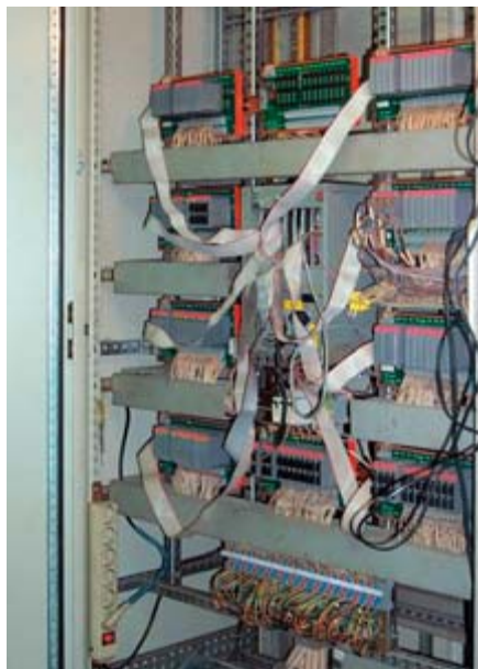
Рис. 7. Оборудование в шкафу управления
