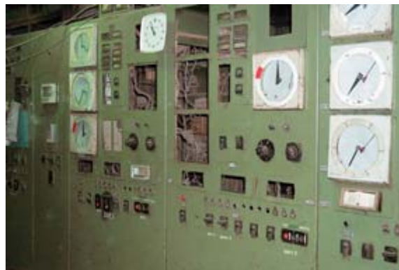
Рис. 9. Щит управления котлом до реконструкции
