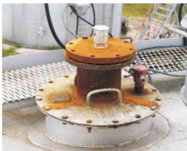
Рис. 5. Размещение уровнемера TS-01 на крыше резервуара
