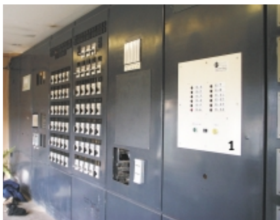
Рис. 10. Панель индикации (1) системы аварийной сигнализации
