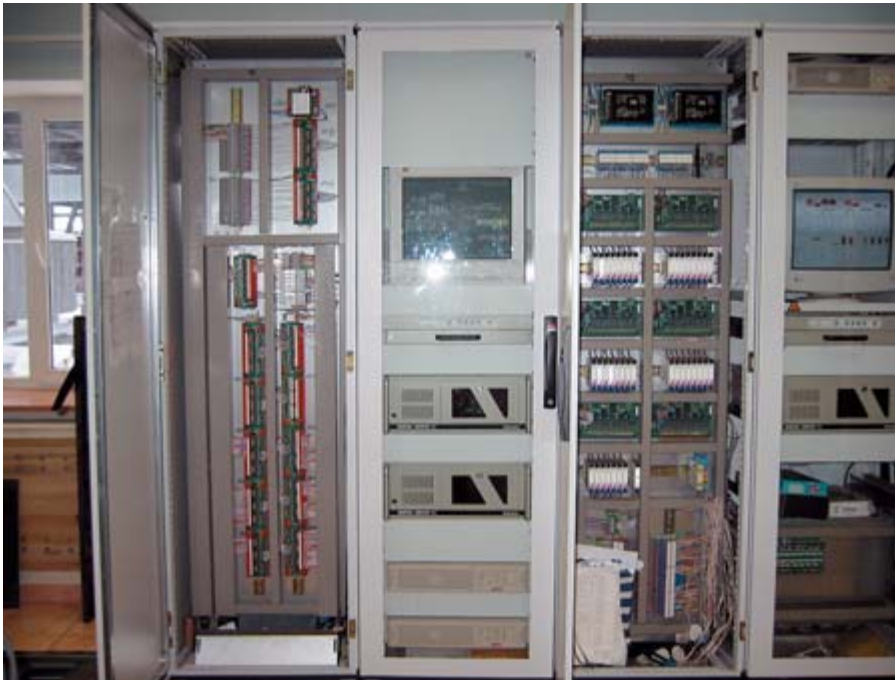
Рис. 2. Стойки с оборудованием сбора данных и управления
