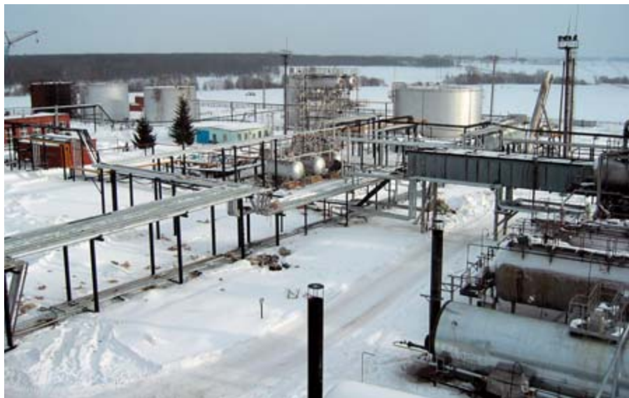
Рис. 1. Технологическое оборудование НСП «Сергеевка»
