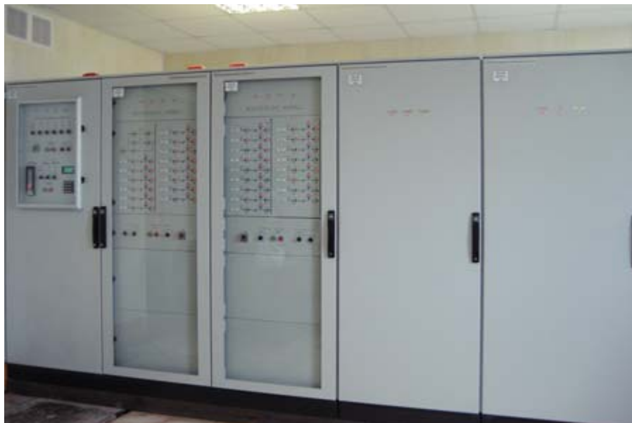
Рис. 4. Шкафы с аппаратурой САУ ГСП
