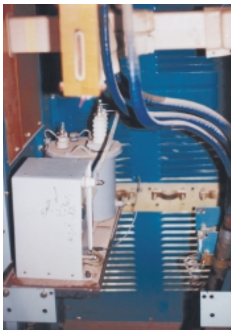
Рис. 6. Блок напряжения в ячейке шинопроводов генератора
