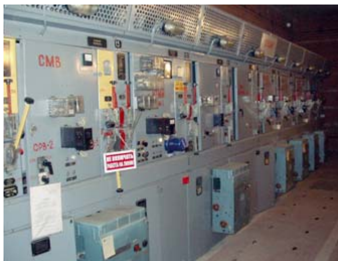
Оборудование распределительного пункта (РП)
