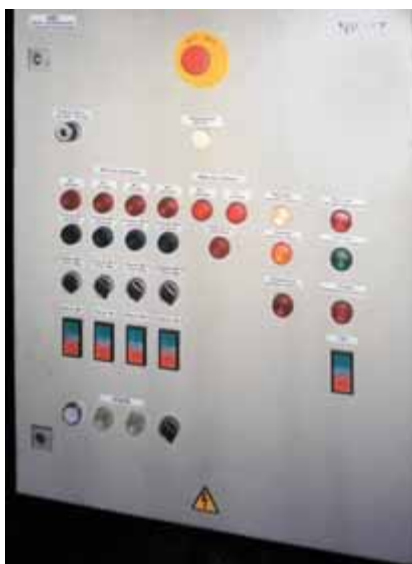
Рис. 5. Пульт управления гидростанцией
