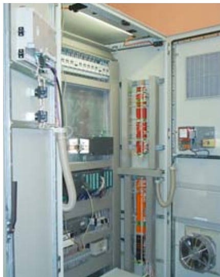
Рис. 7. Общий вид шкафа управления стендом сушки
