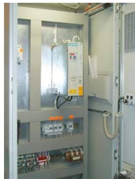
Рис. 5. Общий вид шкафа управления приводом крышки
