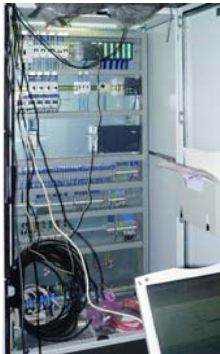
Рис. 4. Общий вид шкафа управления станком
