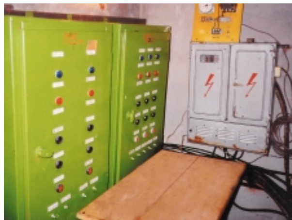
Контролируемый пункт системы телемеханики линейного участка нефтепровода
