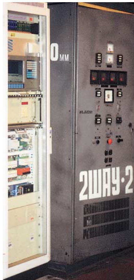
Рис. 5. Шкаф управляющей ЭВМ
