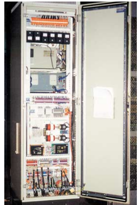
Рис. 6. Шкаф управляющей ЭВМ (вид сзади)
