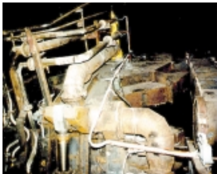
Рис. 2. Стенд сушки и разогрева сталеразливочных ковшей
