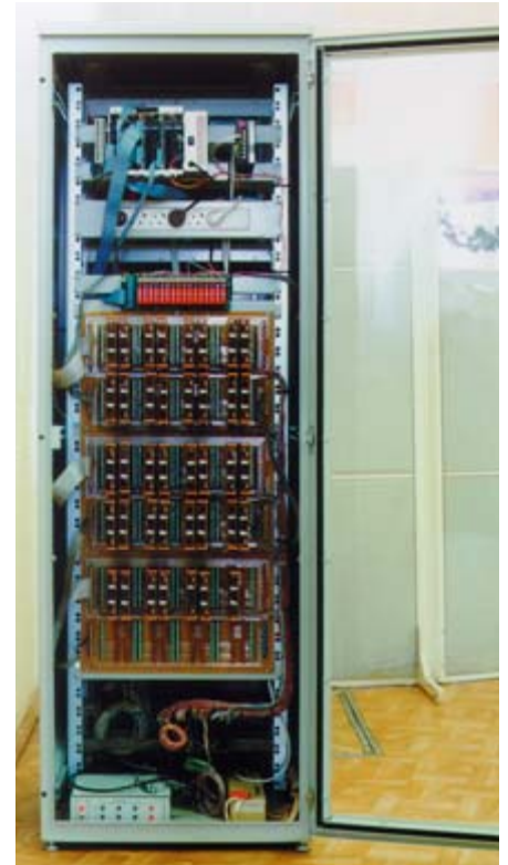
Стойка для подключения к станционным устройствам автоматики
