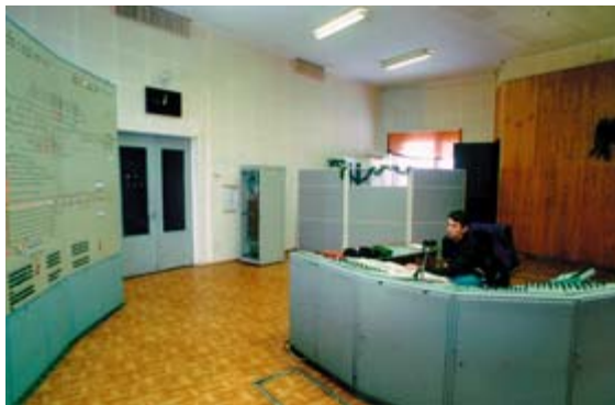
Размещение аппаратуры в помещении дежурного по станции
