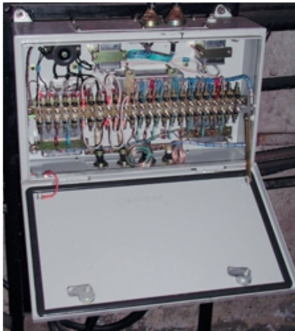
Рис. 11. Трансформаторный ящик (ТЯ) в тоннеле
