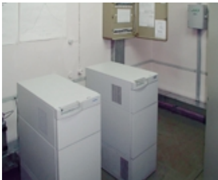
Рис. 10. Фрагмент оборудования системы электропитания СА с ИБП
