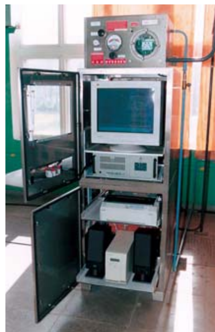
Рис. 5. Размещение вычислительного оборудования во взрывозащитном шкафу
