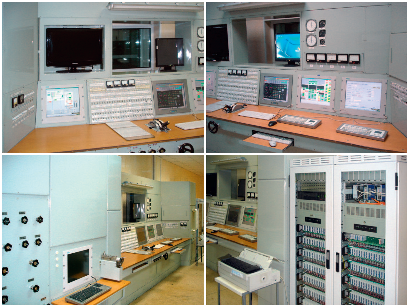
Внешний вид кабины наблюдения испытательного стенда
