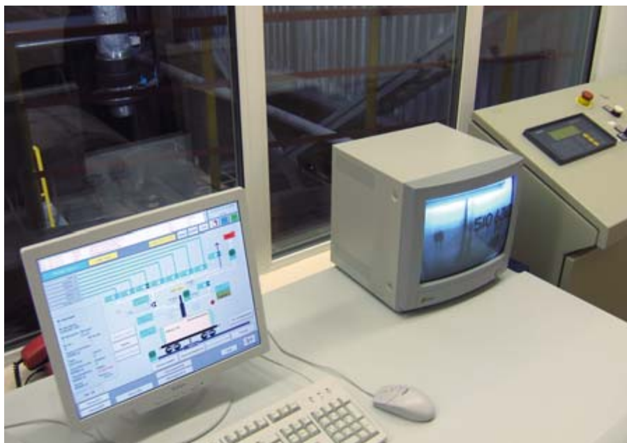
Рис. 5. Оборудование АРМ оператора
