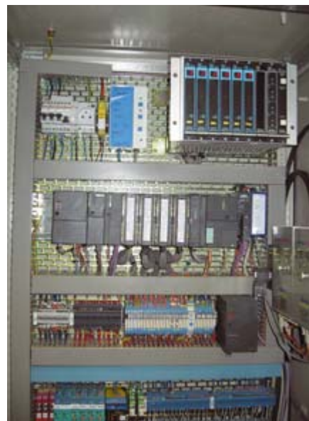
Рис. 4. Шкаф центрального контроллера А3
