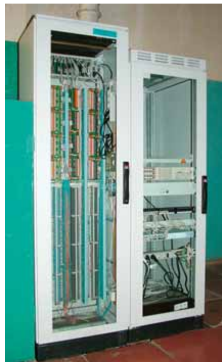
Рис. 3. Шкаф контроллера регистрирующего и шкаф файлового сервера
