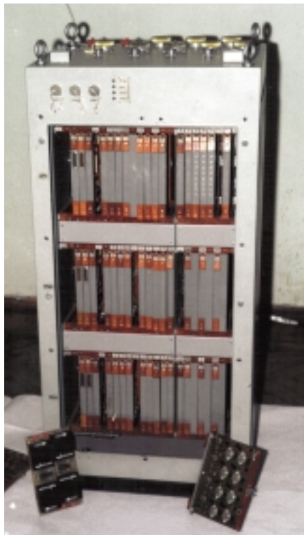
Рис. 4. Шкаф аппаратуры МСУД
