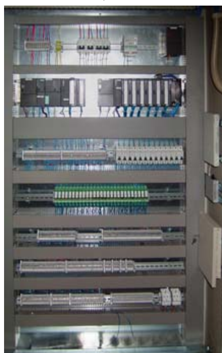
Рис. 3. Шкаф системы управления
