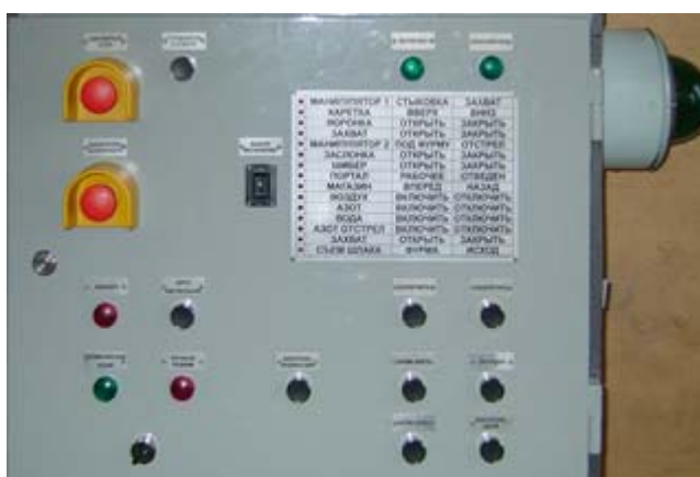
Рис. 4. Шкаф местного управления ПМУ-31
