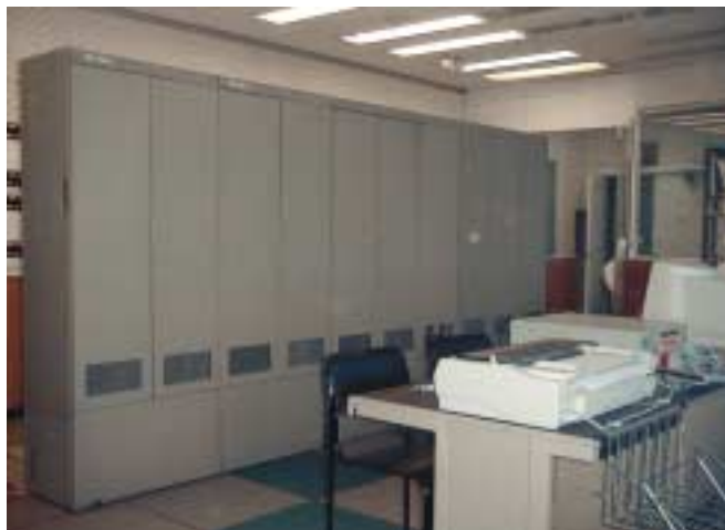
Рис. 2. Шкафы с аппаратурой ПВДС и ПВССУ
