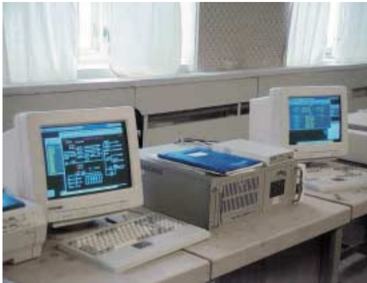
Рис. 7. Серверы системы (основная и резервная станция)
