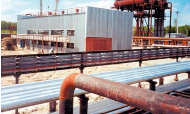
ОАО «Сибнефтепровод»: концепт-сепарационная установка (КСУ) узла учета нефти
