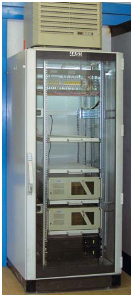
Рис. 4. Шкаф Rittal с промышленными компьютерами
