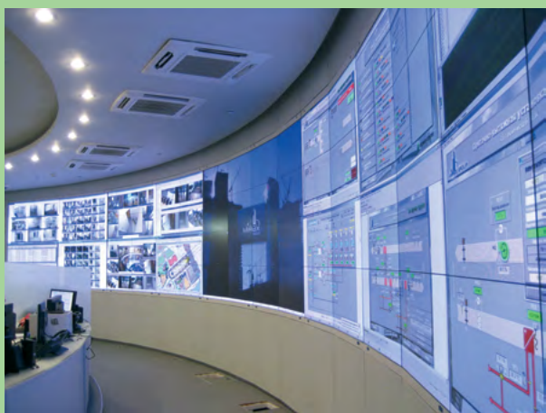
HMI/SCADA в действии. Башня «Федерация» (Запад)
