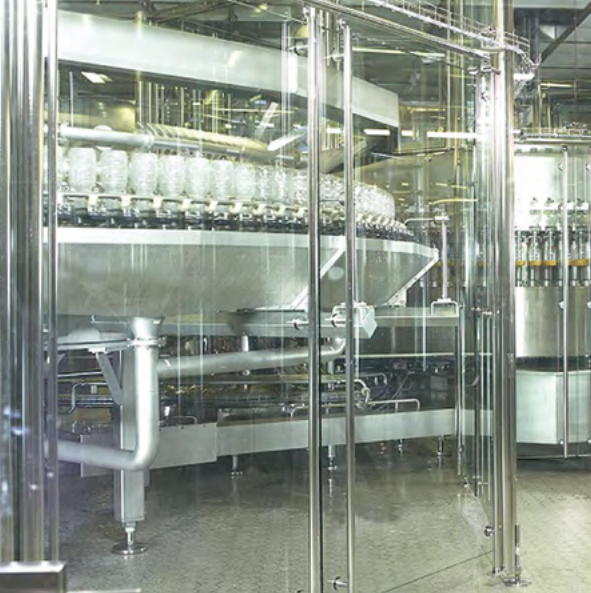
Холодный асептический розлив на заводе напитков KHS Maschinen
