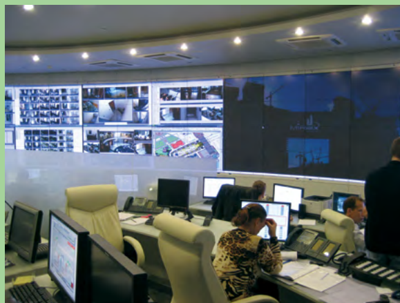
Центр управления зданием в башне «Федерация» (Запад)
