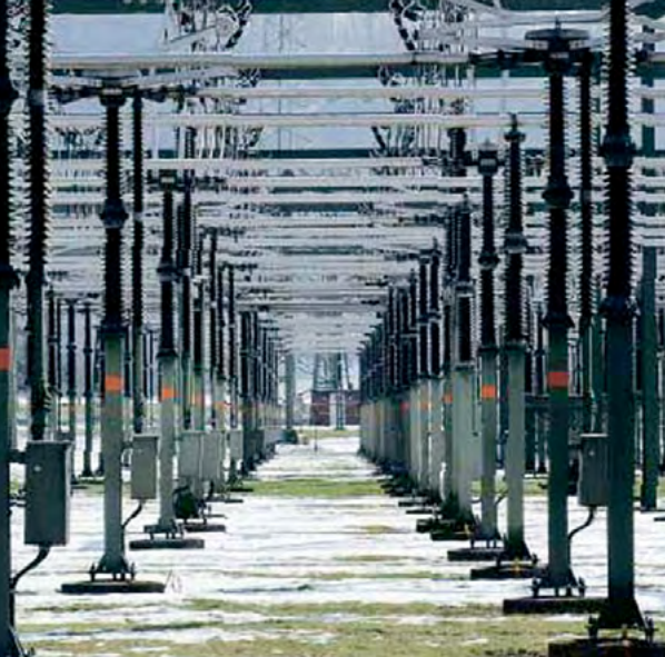
Линии электропередачи, Швейцария
