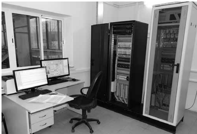
Рис. 4. Внешний вид контроллерных шкафов
