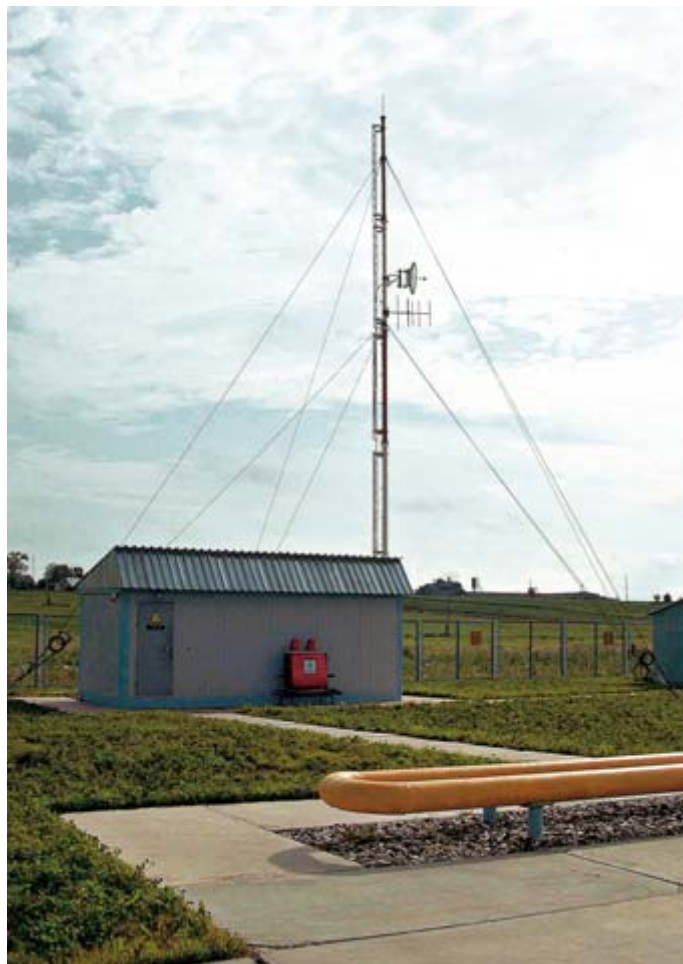
Рис. 2. Блок-бокс контролируемого пункта газораспределительной станции
