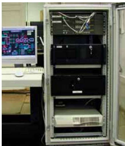
Рис. 7. Общий вид шкафа
