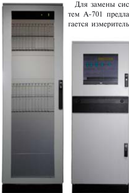
Рис. 1. Шкафы измерительной системы температурного контроля генератора
