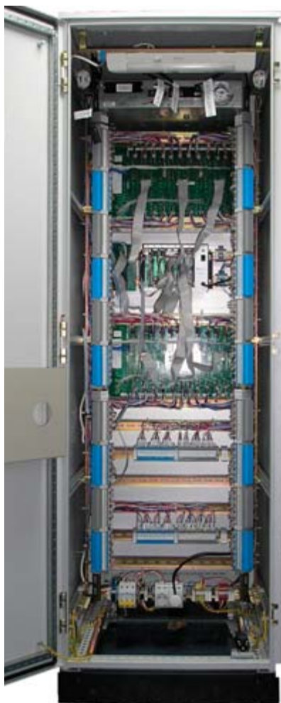
Рис. 2. Размещение устройств в измерительном шкафу
