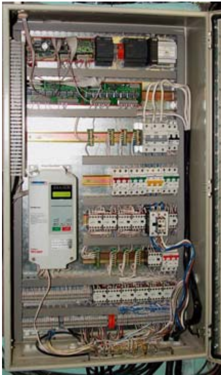
Рис. 6. Шкаф системы управления
