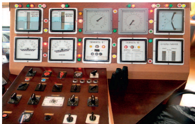
Рис. 7. Штатный пульт управления шлюзом в башне ЦПУ
