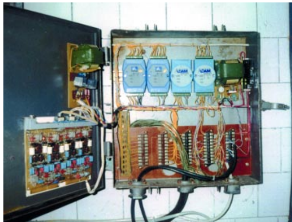
Рис. 4. Шкаф с оборудованием в эжекторной
