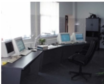
Рис. 4. Комната операторов АСУ ТП
