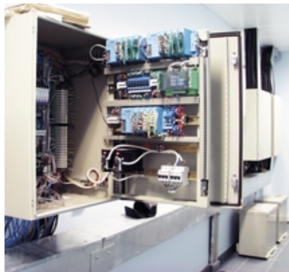
Рис. 7. Один из шкафов АСУ ТП ПСТ-2
