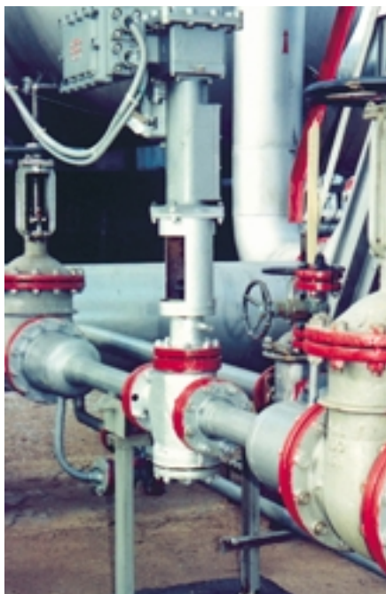
Рис. 4. Исполнительный механизм — электрифицированная задвижка
