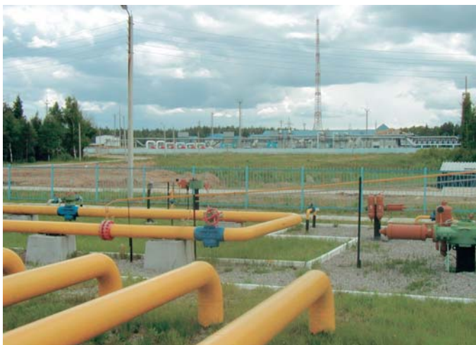
Вид на компрессорную станцию
