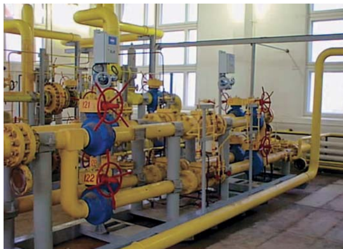
Газораспределительная станция, участок измерения расхода газа
