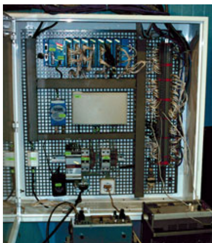
Рис. 4. Аппаратура новой системы в помещении старой операторской (момент пусконаладочных работ)
