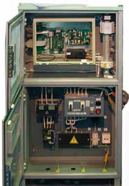
Рис. 4. Совмещённая станция управления скважиной
