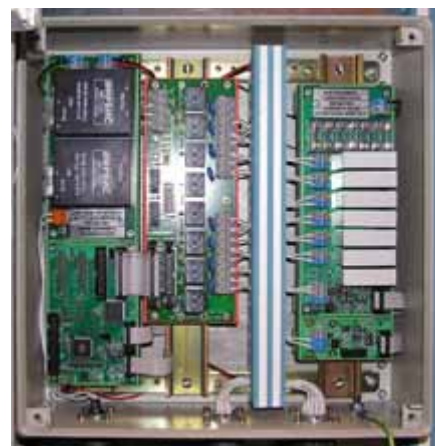
Рис. 10. Монтажная панель контроллера ПЕ2.781.001 системы ЦВА
