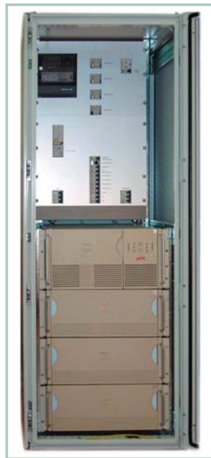
Рис. 3. Щит распределительный САУ ГРС
